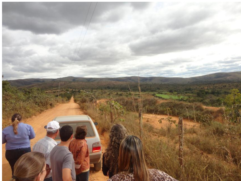
Figura 19: Vista das bacias de contenção sem manutenção e dos consequentes processos erosivos.
